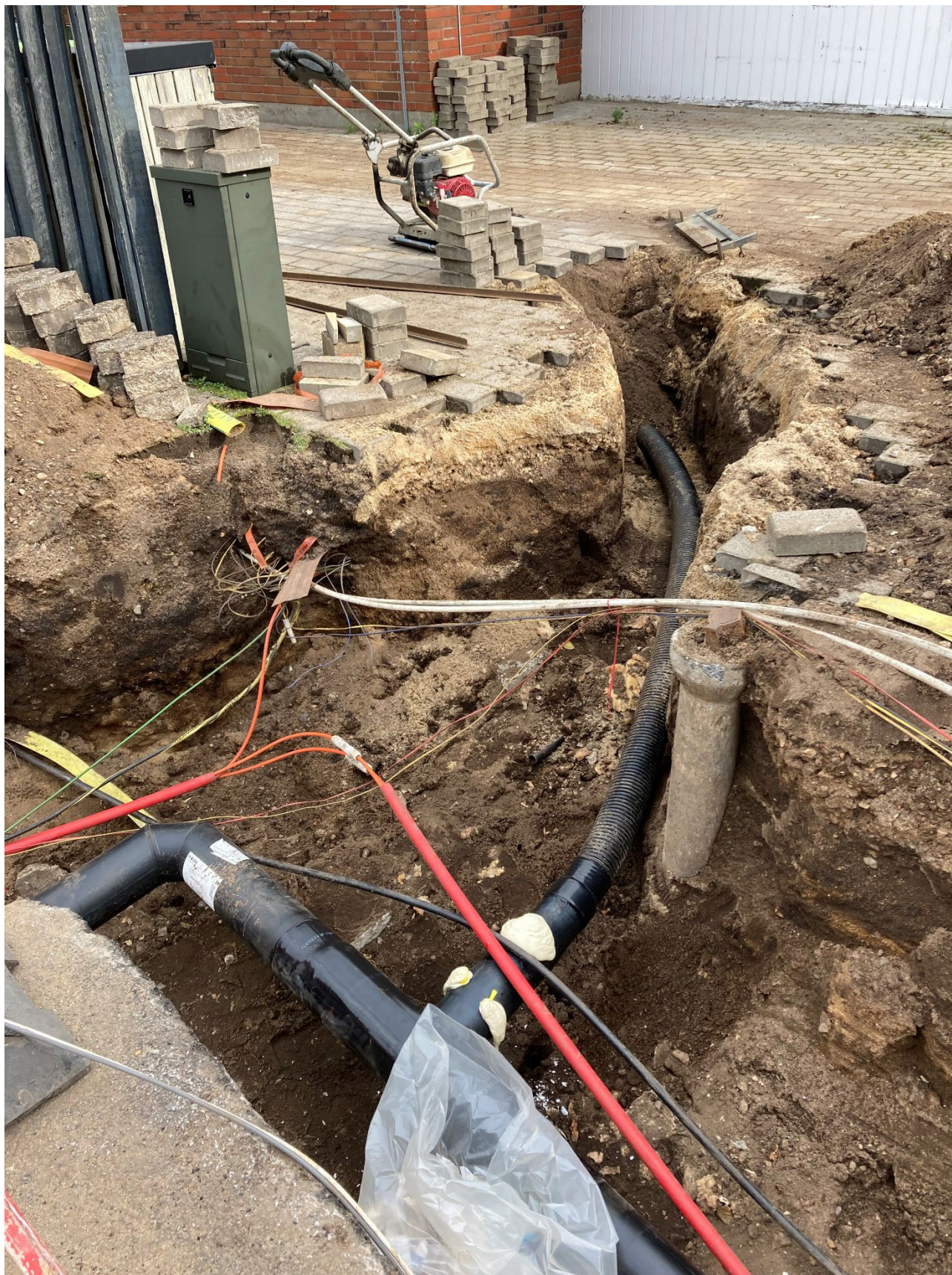
Tilslutning til fjernvarme. Foto: GEV
